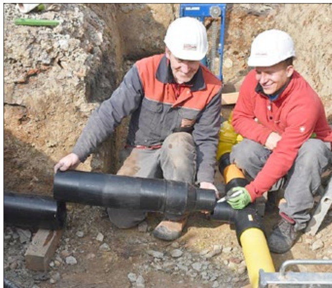
Martin Beyer (links) und Pascal Rönick von der Firma Elektrobau Bellinger aus Schönstedt binden Wendehausen von Katharinenberg aus an das Erdgas-Netz an. Foto: Reiner Schmalz
